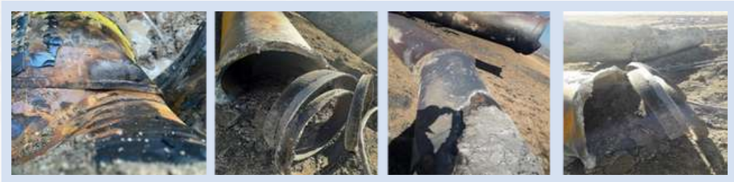
Şekil 18: Deprem sonrası RMS-A çıkışı boru hasarları.
