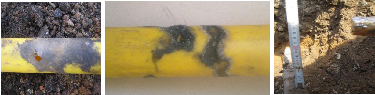
Elektrik hattı-gaz boru hattı geçiş hasarı örneği
